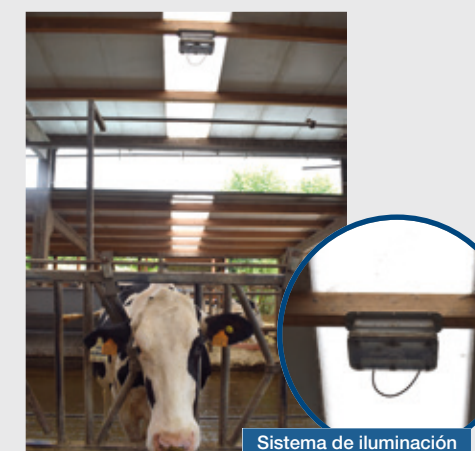
Sistema de iluminación
