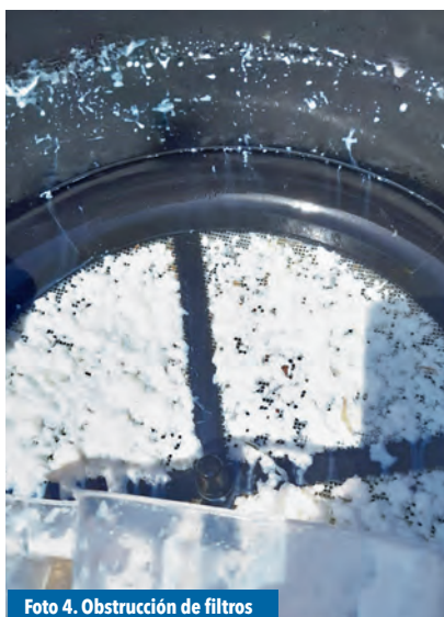
Foto 4. Obstrucción de filtros
