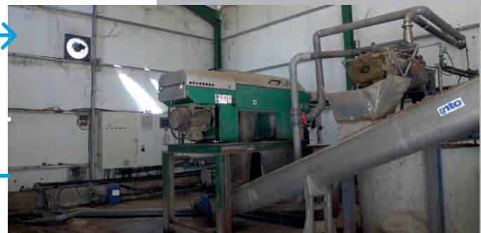
Planta de clarificación y deshidratación de purín
