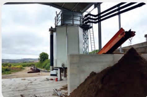
Instalación de HBC1000 en Sat Arronte (Cantabria)
