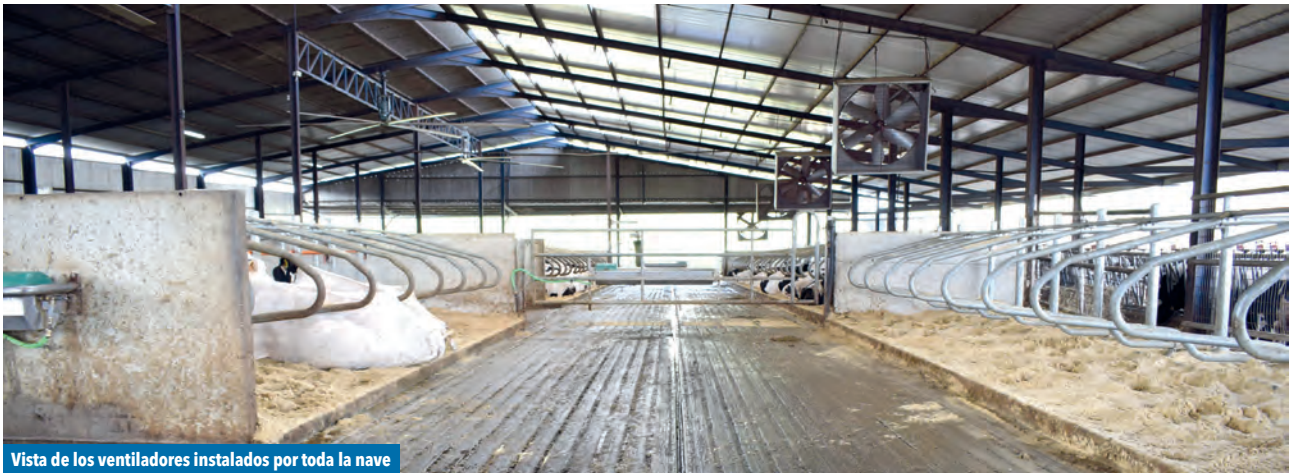
Vista de los ventiladores instalados por toda la nave
